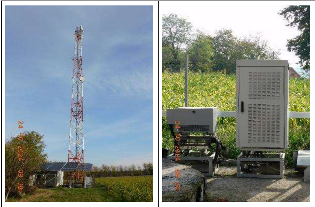
Slika 2.3 Antenski stub i kabinet bazne stanice
