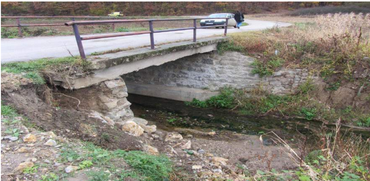
Оштећен мост на Пардичкој реци на општинском путу Ражањ – „Јерски луг“
