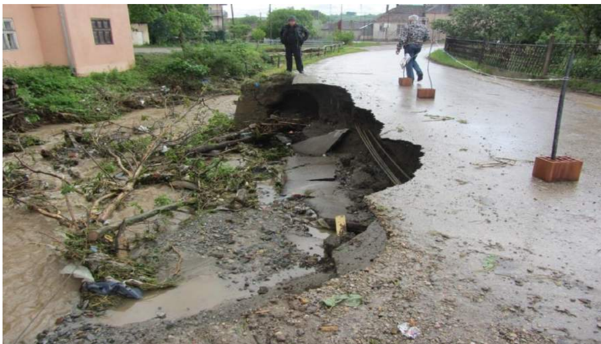
Фотографија оштећења дела пута у Смиловцу , мај 2014. године.
